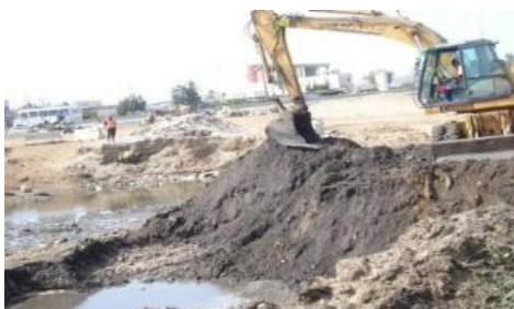
Document 4 : Après la démolition des habitations, le dessouchage des arbres, viennent les travaux de purge de la zone.
