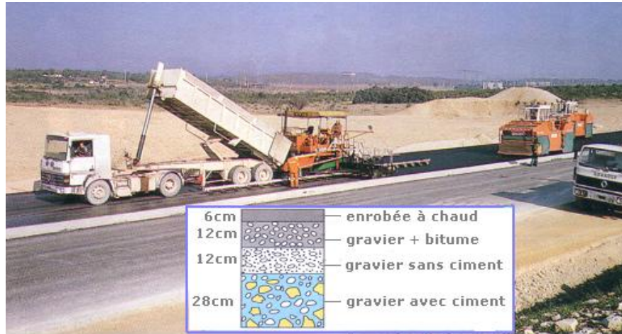
Document 7 : Pose de l'enrobée à chaud. Sous cette couche de finition plusieurs autres couches constituent le soubassement de l'autoroute.
